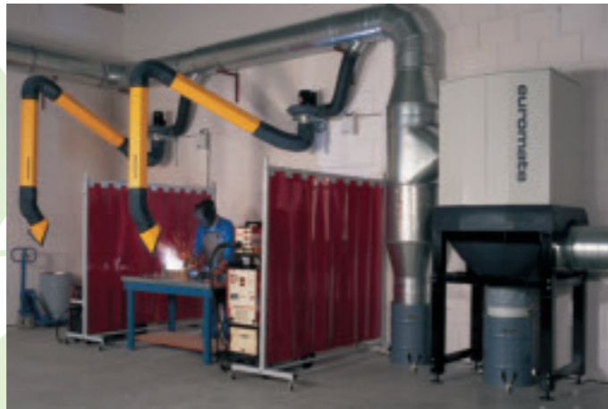
SCS suodatin johon on liitetty joustavat Euromate imuvarret ja puhallinmoottorit.
